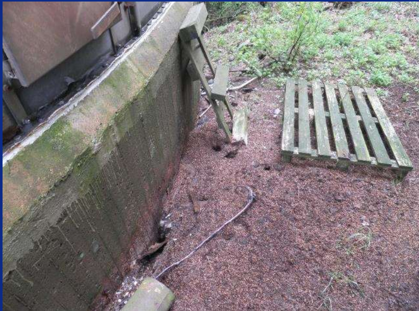
Före: Mat, gömställen och råttor
